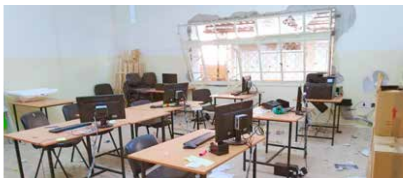
Ein Gebäude der Caritas in Beirut wurde im August bei einer Explosionskatastrophe schwer beschädigt.
